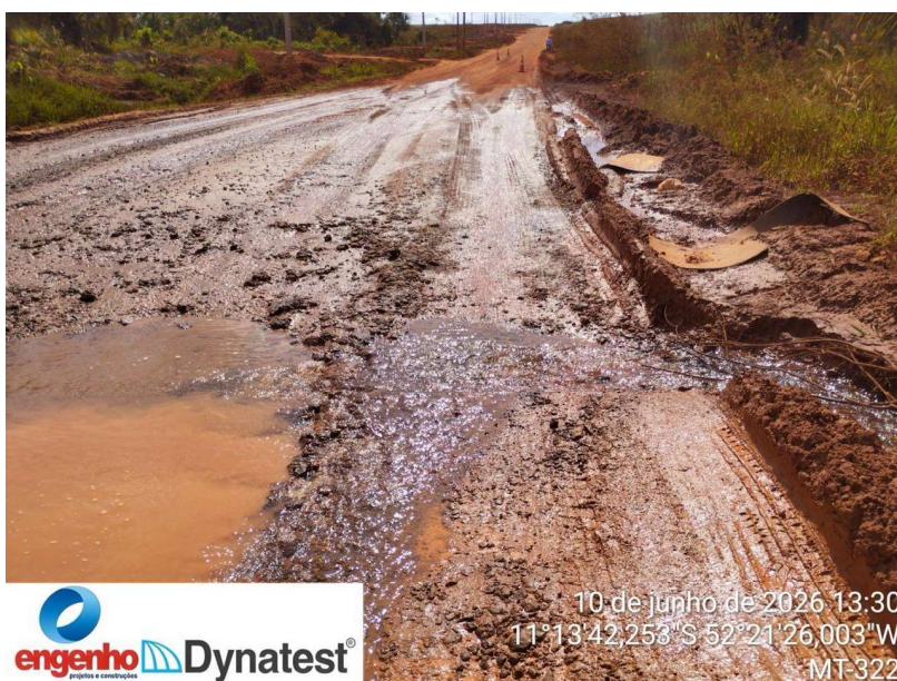
FOTO 18 – ÁREA ONDE FOI CONSTATADO O ATERRAMENTO DA DRENAGEM NATURAL, RESULTANDO NA OBSTRUÇÃO DO FLUXO HÍDRICO E NO ESCOAMENTO DA ÁGUA SOBRE A PISTA
