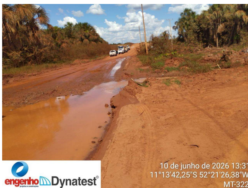
FOTO 20 – ÁREA ONDE FOI CONSTATADO O ATERRAMENTO DA DRENAGEM NATURAL, RESULTANDO NA OBSTRUÇÃO DO FLUXO HÍDRICO E NO ESCOAMENTO DA ÁGUA SOBRE A PISTA
