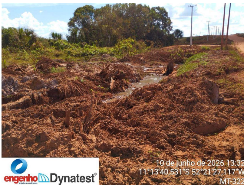
FOTO 21 – VISTA GERAL DA ÁREA DEGRADADA
