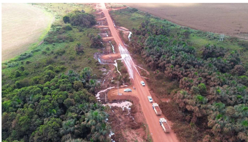
FOTO 24 – VISTA GERAL DA ÁREA DEGRADADA
