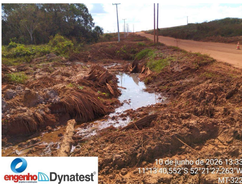
FOTO 12 – ÁREA DE NASCENTE ATERRADA EM DECORRÊNCIA DA MOVIMENTAÇÃO DE SOLO
