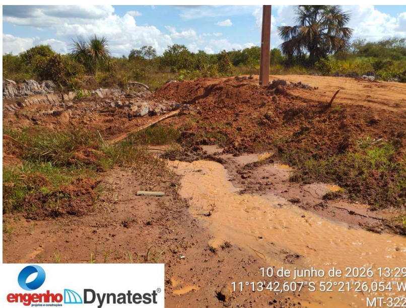
FOTO 22 – VISTA GERAL DA ÁREA DEGRADADA
